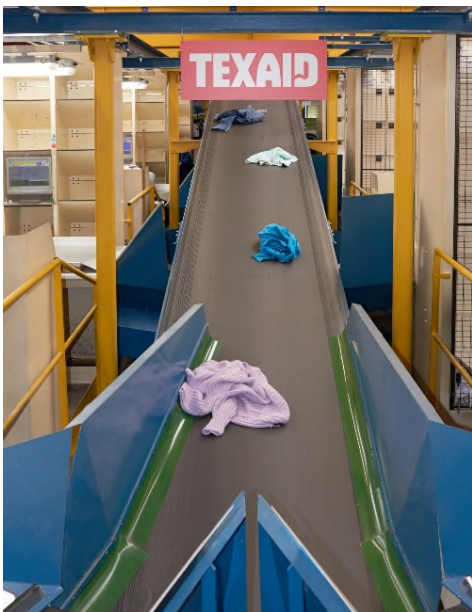
Eine der europaweit modernsten Sortieranlagen am Hauptsitz in Schattdorf (UR).
